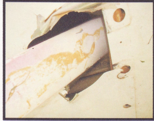
Fotografía No. 10 Vista de daños en la estructura soporte del tren derecho
