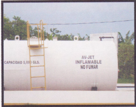
Fotografía No.17 Vista depósito de combustible
